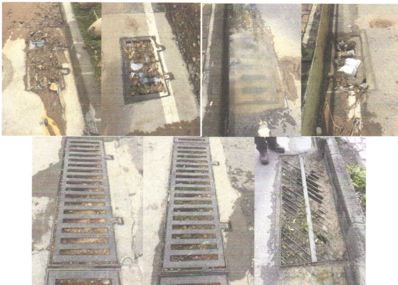
Figura 3. Pérdida de Capacidad en Rejillas Colmatadas.
