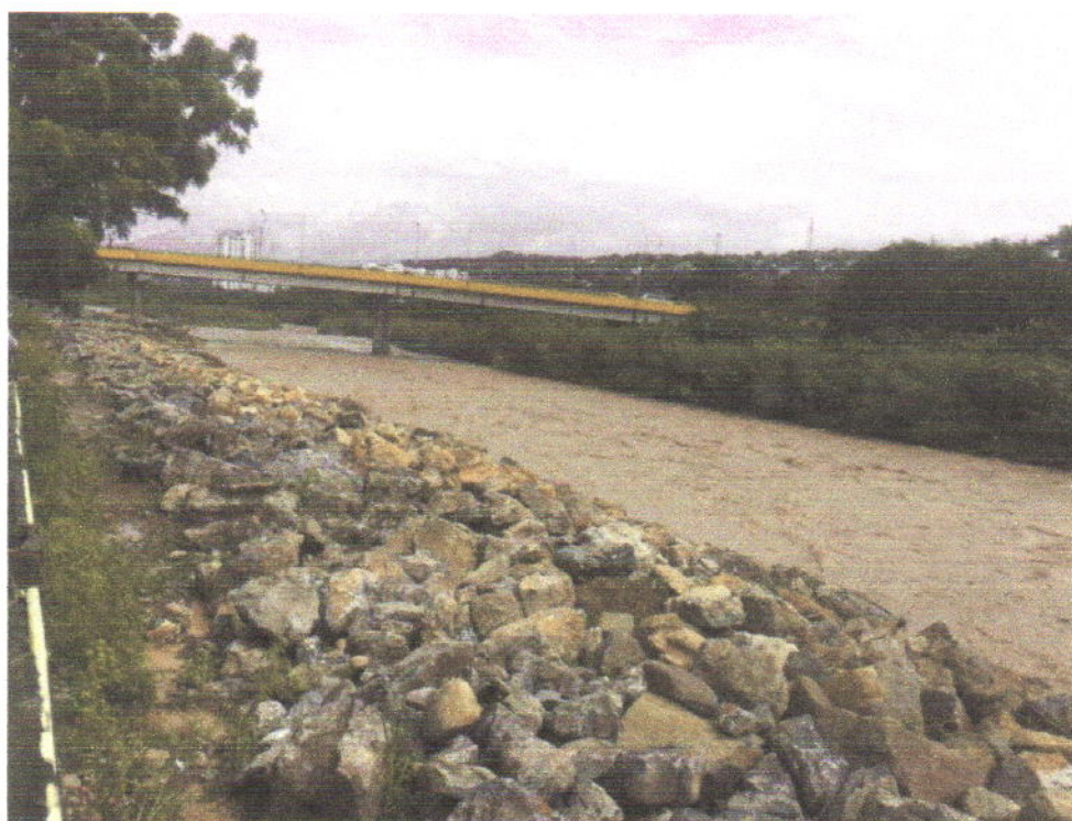
Figura 2. Estabilidad del Enrocado Instalado.
